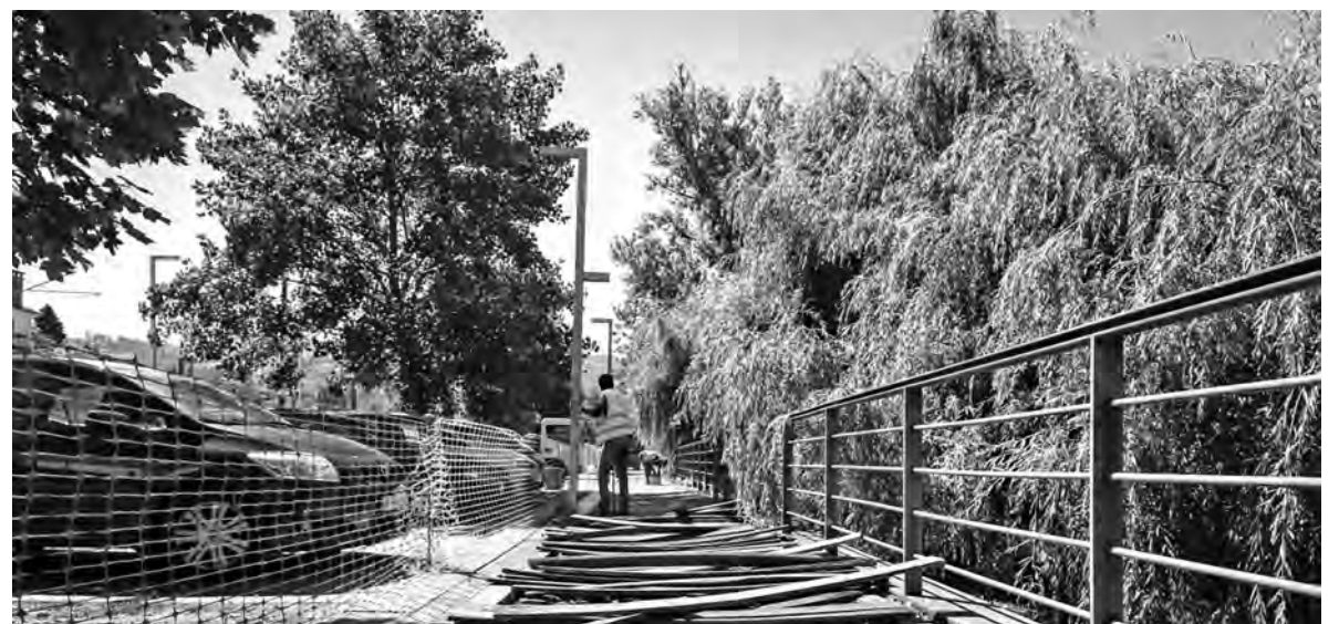
TRAVES DE MADEIRA VÃO SER SUBSTITUÍDAS POR PISO À BASE DE BETÃO
